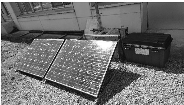
図9 水路設置型ハイブリッド分離装置システムの動作実験の様子
